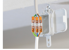
Leuchtenanschluss in Zwischendecken
